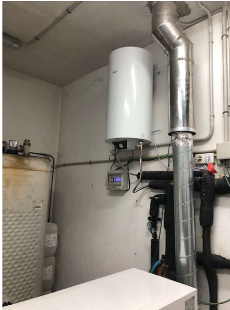
Escalfador de gasoil
