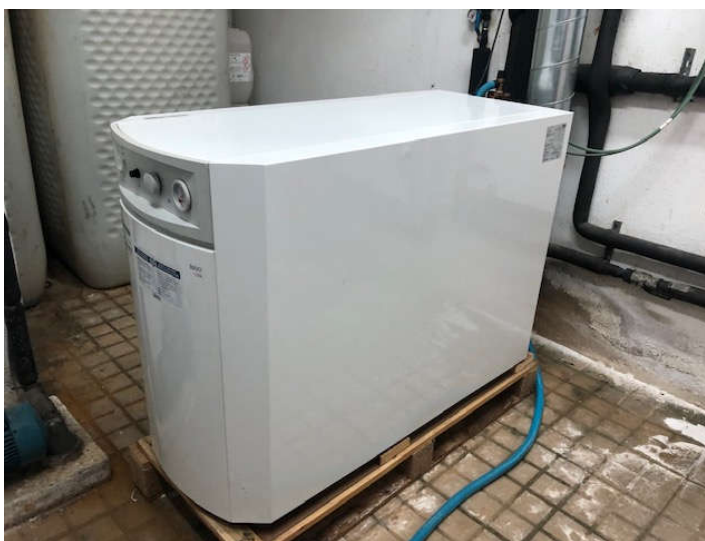
Caldera de gasoil
