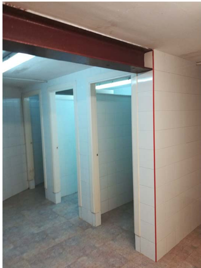
FOTO 3. VENTILACIONS AL FINAL DELS BANYS HOMES-DONES
