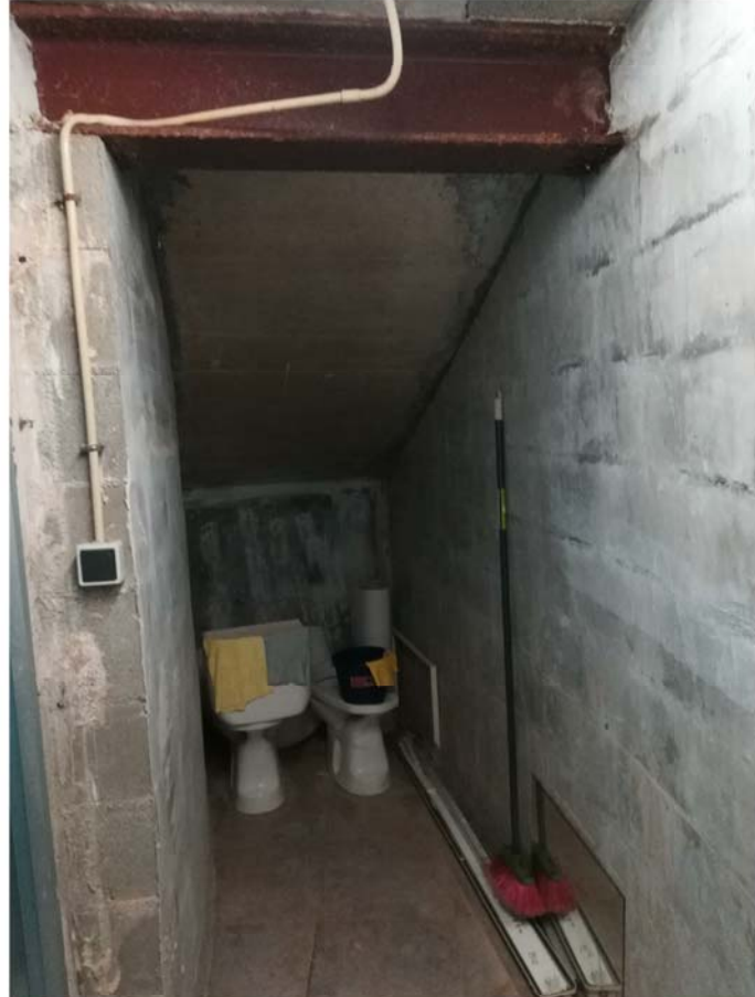
FOTO 6. MAGATZEM 2 OXIDACIO A VIGUES METAL.LIQUES
