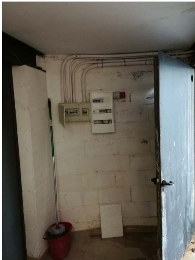
FOTO 1. ENTRADA: QGP ELECTRIC I ENTRADA D'AIGUA SOBRE PORTA
