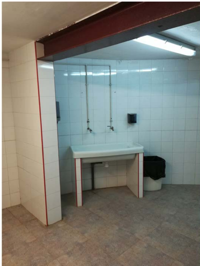
FOTO 2. WC HOMES BIGUES METAL.LIQUES AMB OXIDACIO MENOR
