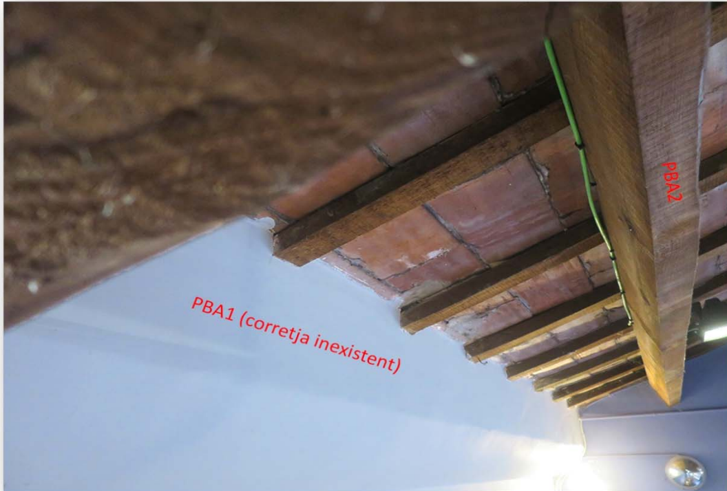
Sostre de la planta baixa (PB). Element PBA1. Imatge 612 Corretja inexistent
