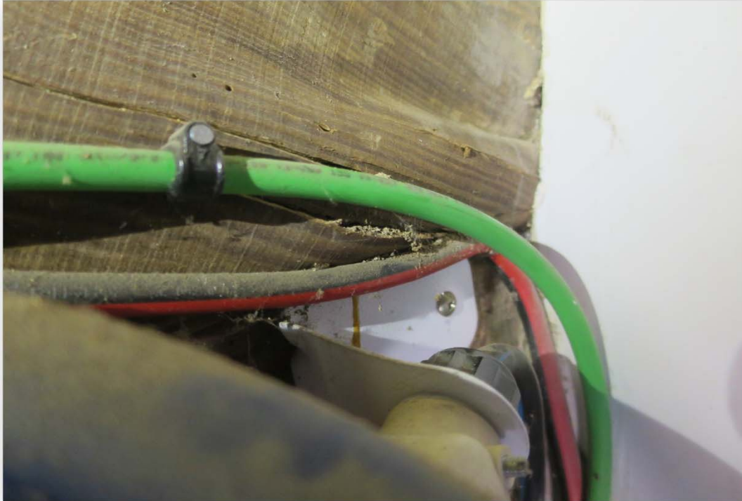
Sostre de la planta baixa (PB). Element PBE3 (encavallada). Imatge 606 Degradació causada per tèrmits subterranis Aixafament del recolzament en l'extrem sud-est
