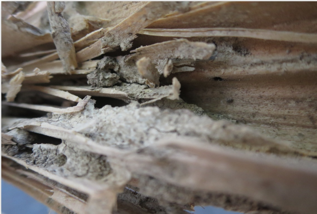
Sostre de la planta baixa (PB). Element PBE3 (encavallada). Imatge 607 Degradació causada per tèrmits subterranis Construccions de tèrmits subterranis
