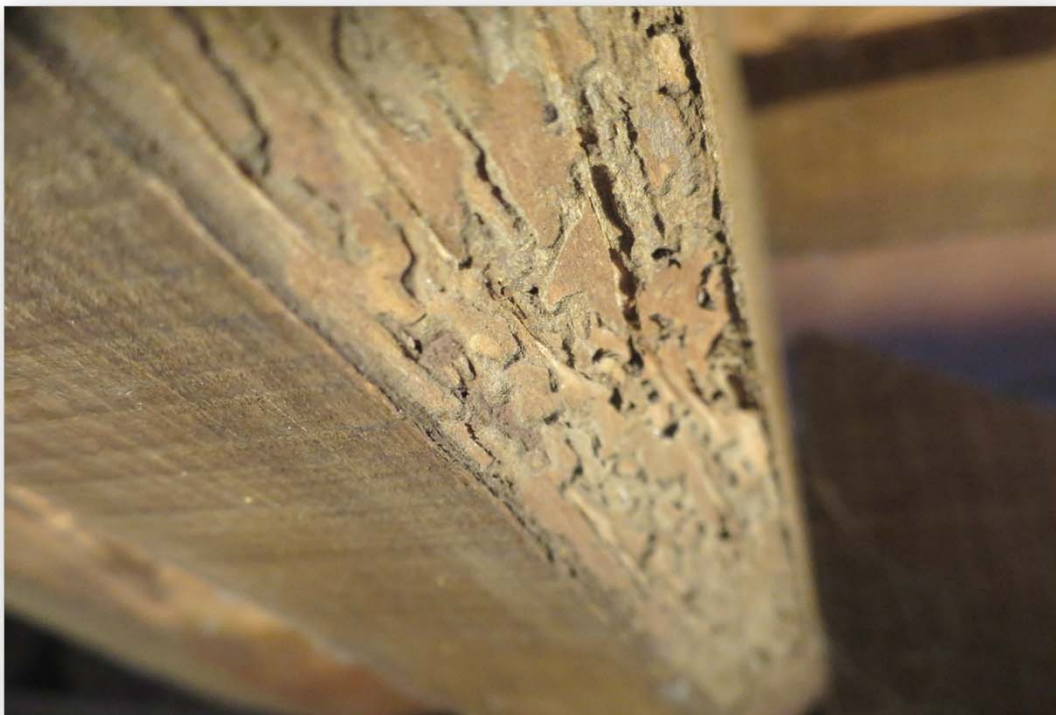
Sostre de la planta baixa (PB). Imatge 609 Afectació general lleu de corc; corc actiu
