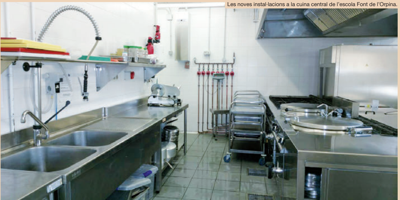
Les noves instal·lacions a la cuina central de l'escola Font de l'Orpina.
